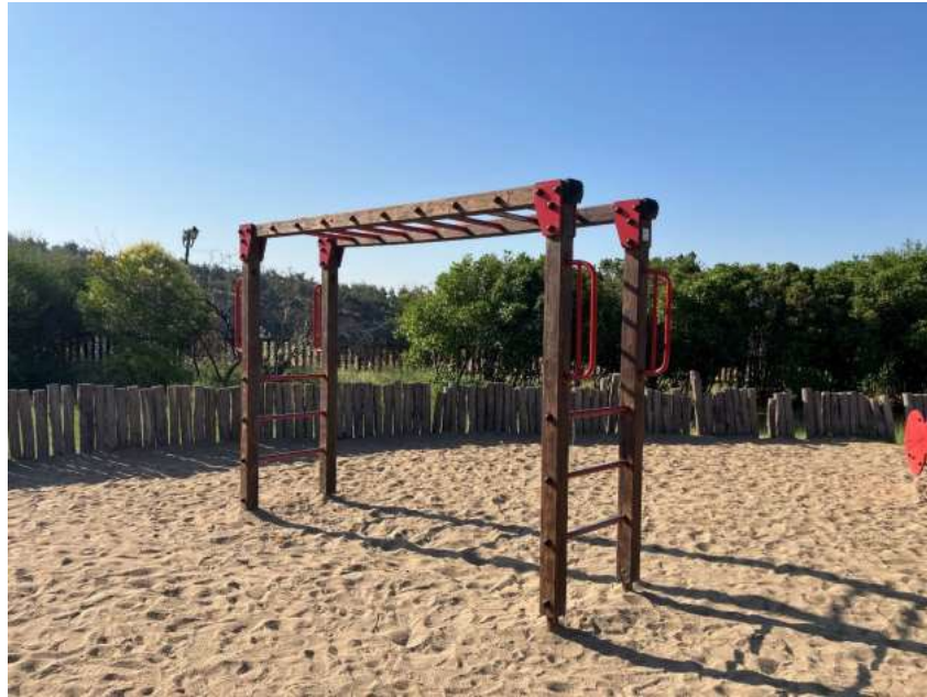
Εικόνα 4 Όργανο αναρρίχησης προς αντικατάσταση (Τμήμα Α)
