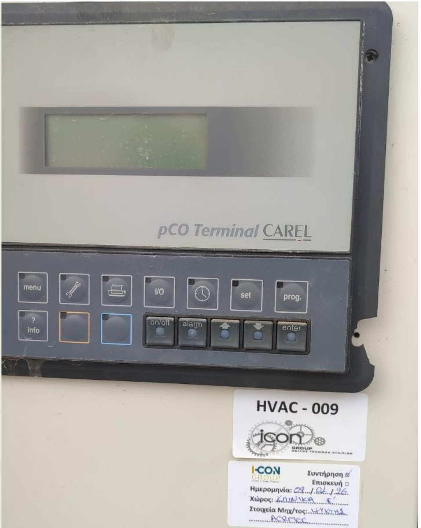
ΧΕΙΡΙΣΤΗΡΙΟ-ΘΘΟΝΗ / AERMEC HVAC-009
