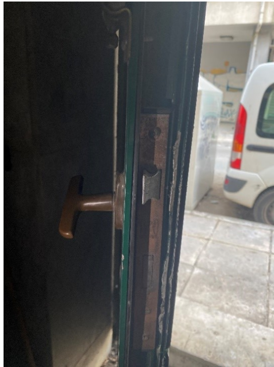
Παραβίαση θύρας εξόδου υπογείου επί της οδού Αγησιλάου 9
