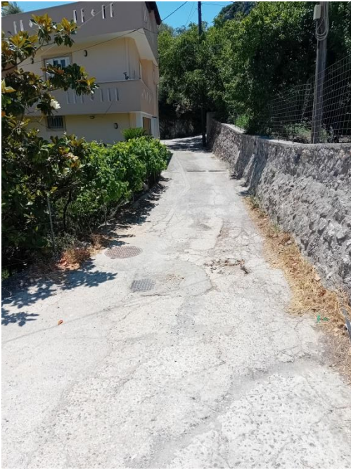
Εικόνα 3: τμήμα της οδού με εκτεταμένες ρωγματώσεις
