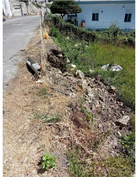
Εικόνα 4: Υφιστάμενη λιθοδομή σε τμήμα της κεντρικής οδού που έχει καταρρεύσει
