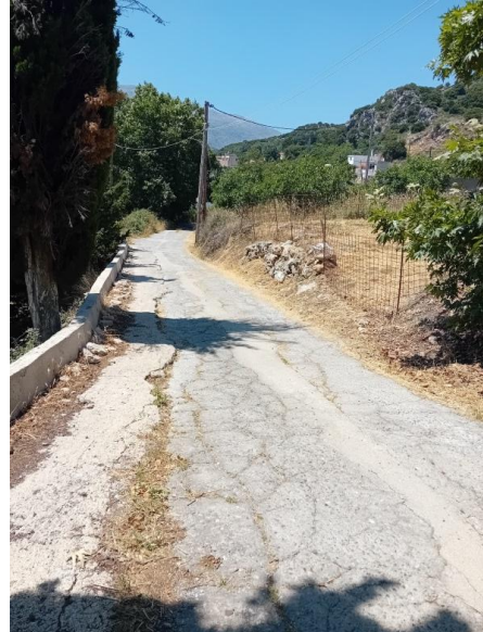
Εικόνα 2: τμήμα της οδού με εκτεταμένες ρωγματώσεις
