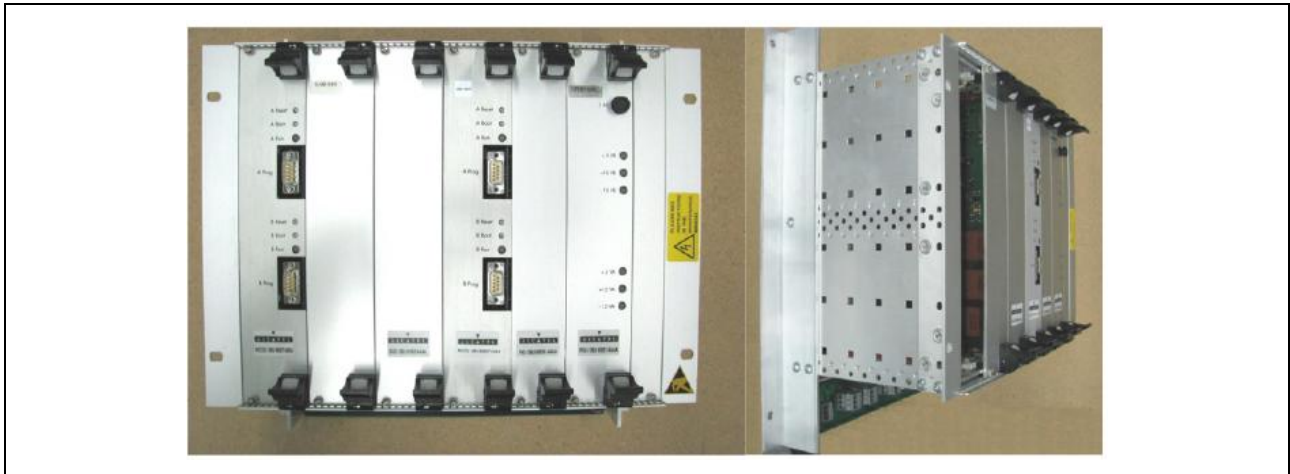
Εικόνα 275: Τοποθετημένα Στοιχεία Εξοπλισμού Ηλεκτρονικής Μονάδας (LEU)
