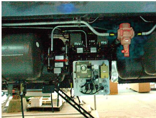
Εικόνα 9-1: Ηλεκτροπνευματικός Πίνακας Ελέγχου Πέδησης
