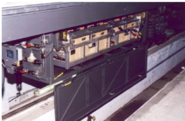
Εικόνα 12-4: Κιβώτιο Συσσωρευτών και Συσσωρευτές
