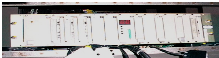
Εικόνα 9-2: Μονάδα Ελέγχου Πέδησης
