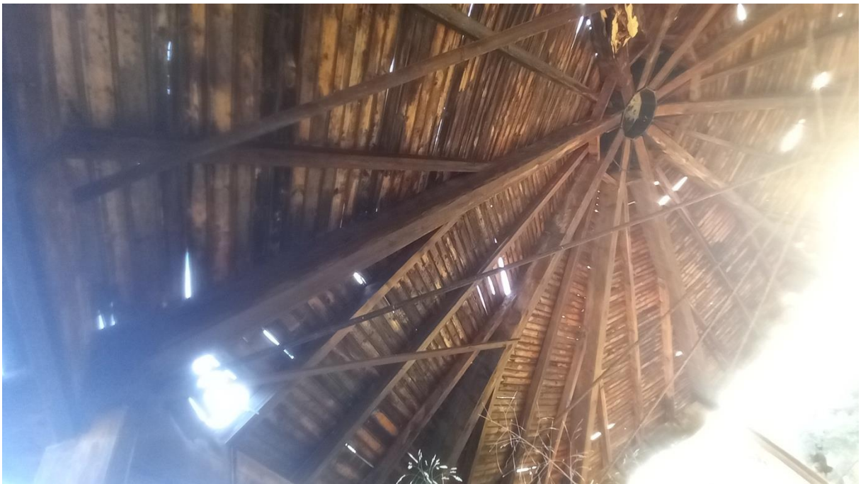
Εικ. 6.: Άποψη των φθαρμένων στοιχείων της ξύλινης επικάλυψης του στεγάστρου
