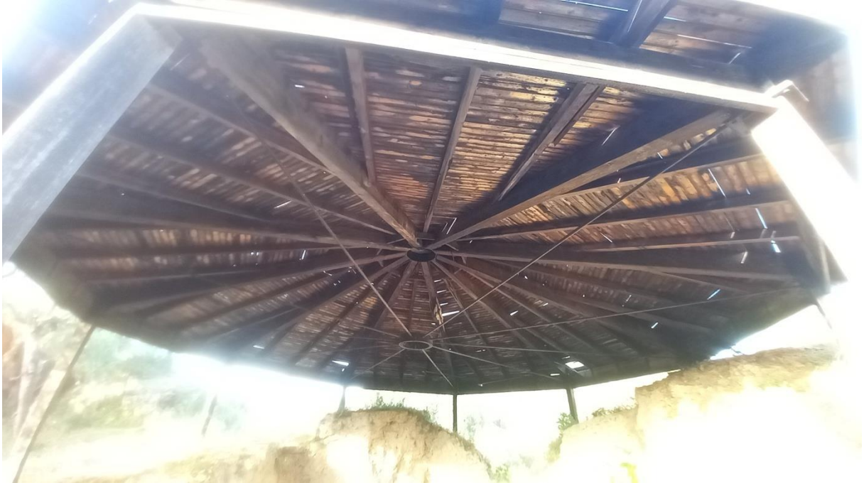
Εικ. 5.: Άποψη των φθαρμένων στοιχείων της ξύλινης επικάλυψης του στεγάστρου
