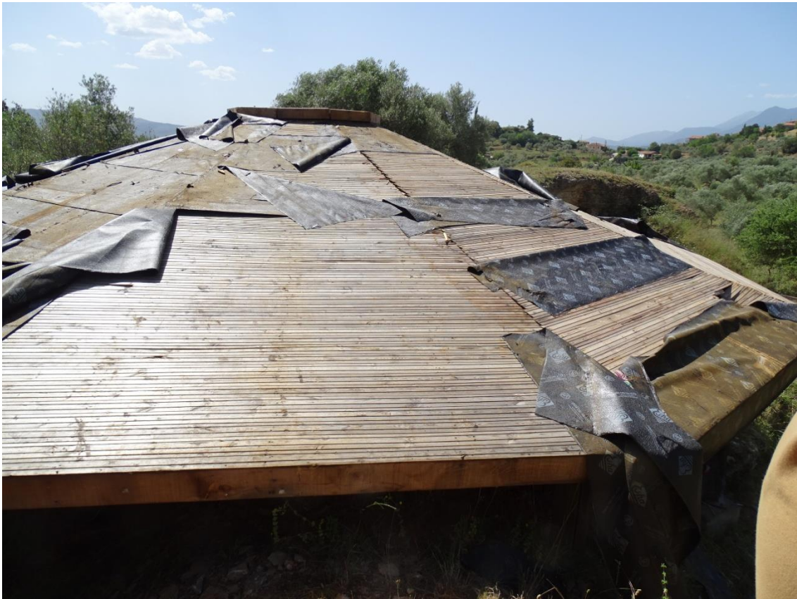
Εικ. 8: Άποψη του στεγάστρου μετά τη βίαιη απόσπαση των μεταλλικών φύλλων
