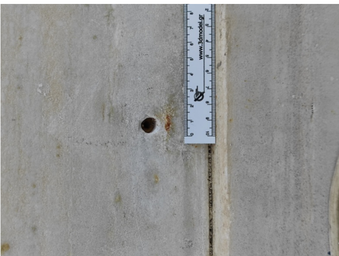
Εικ. 16. Στα αρχιτεκτονικά μέλη σποραδικά υπάρχουν παλαιότερες οπές.
