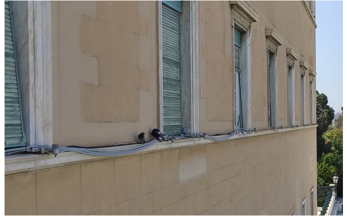
Εικ. 10. Τα φωτιστικά διαδοχικών παραθύρων συνδέονται μέσω καλωδιώσεων τοποθετημένων στην άνω πλευρά της μαρμάρινης ταινίας
