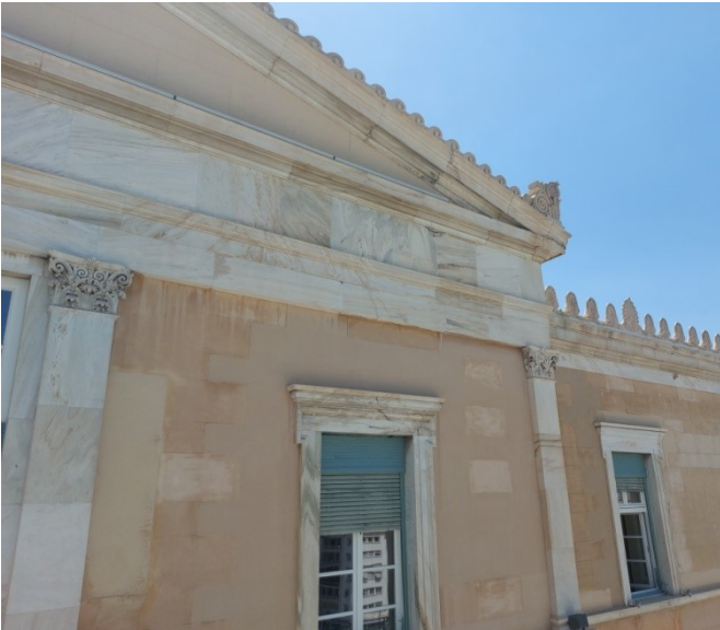
Εικ. 12. Φωτιστικό σώμα εγκατεστημένο στο οριζόντιο γείσο για τον φωτισμό του αετώματος (Φωτογραφία Ε. Δουδούμη)
