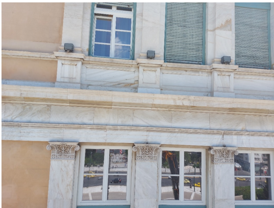
Υφιστάμενη κατάσταση στις παραστάδες του β' ορόφου της Δυτικής όψης.
