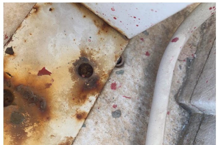
Εικ.17. Οξειδωμένα μεταλλικά στοιχεία στήριξης παλιών φωτιστικών σωμάτων. Διακρίνονται οι οπές καθώς και παλαιότερες οπές με υπολείμματα υρατ
