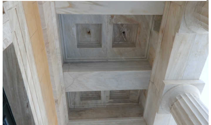
Εικ. 15. Στις οροφές των φατνωμάτων του δυτικού προπύλου, τα φωτιστικά έχουν αφαιρεθεί ωστόσο υπάρχουν οι οδεύσεις καθώς και οι θέσεις ανάρτησης.
