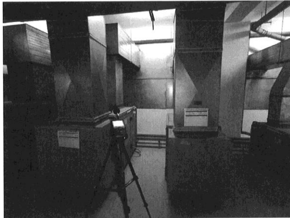
Εικόνα 6: Ηχομέτρηση εντός μηχανοστασίου 4 ου ορόφου προς ανατολική πλευρά
